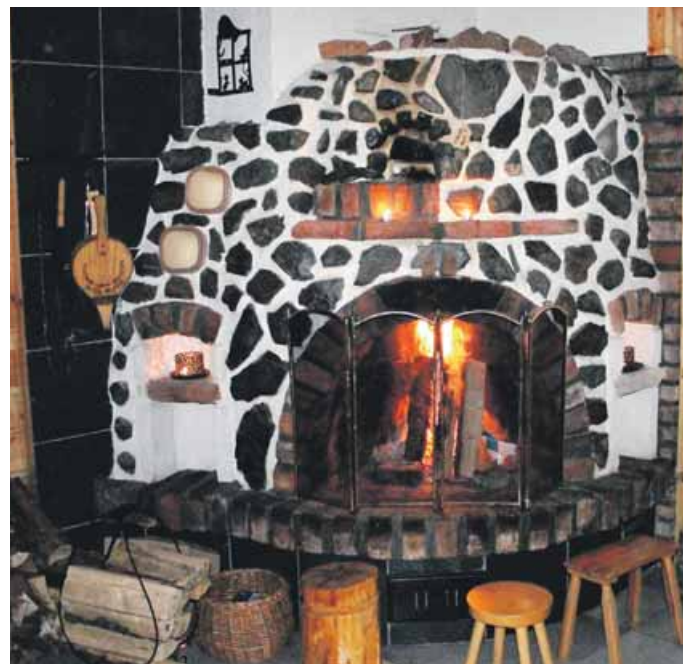
Luonnonkivistä muurattu varaava takka.
